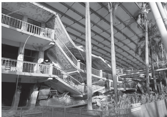
被災した中学校の校舎
